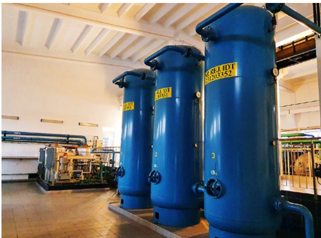
Zbiorniki sprężonego powietrza
