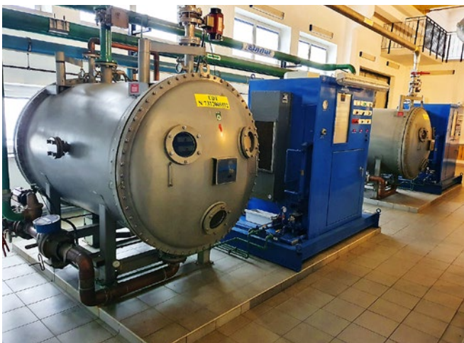
Obecnie pracujące generatory ozonu
