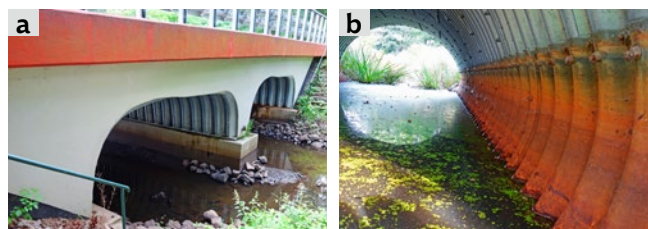
Ryc. 2. Przykłady przepustów o różnej konstrukcji, a zatem o różnych parametrach hydraulicznych: a) przepust dwuotworowy o przekroju otwartym – widoczna jest przegroda środkowa w obrębie cieku, b) strefa wewnętrzna przepustu o przekroju zamkniętym – widoczne okresowe wahania poziomu wody w przepuscie
