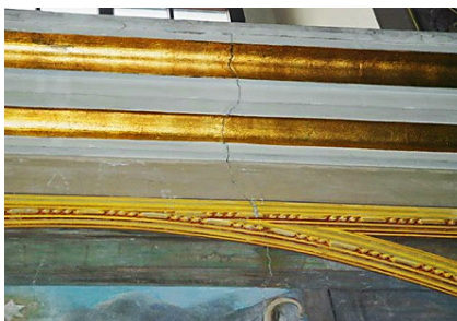
Ryc. 5. Pęknięcia ściany wewnątrz kościoła, fot. B. Gostyńska
