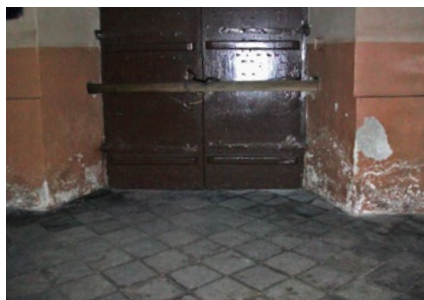
Ryc. 3. Zniszczenia dolnych partii murów wewnątrz kościoła, fot. B. Gostyńska
