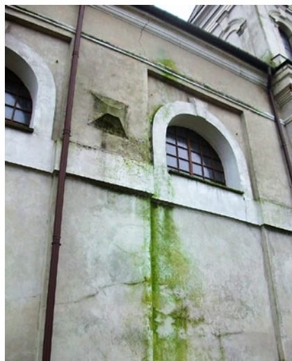
Ryc. 4. Zniszczenia ścian zewnętrznych kościoła, fot. B. Gostyńska
