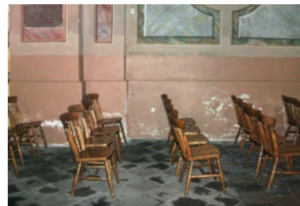
Ryc. 2. Zawilgocenie posadzki wewnątrz kościoła, fot. B. Gostyńska
