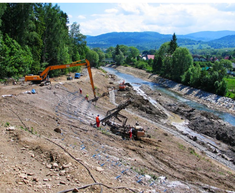
Ryc. 4. Prace nad zabezpieczeniem osuwiska przy Trakcie Cesarskim w Węgierskiej Górze w Beskidzie Śląskim
