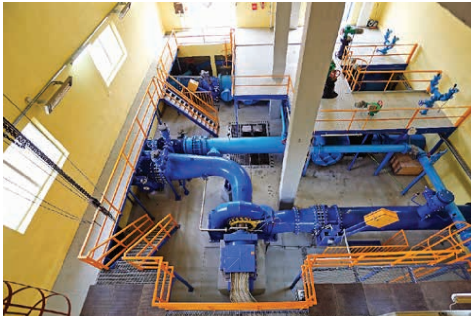
Turbina w komorze KP3 w ZUW Raba
