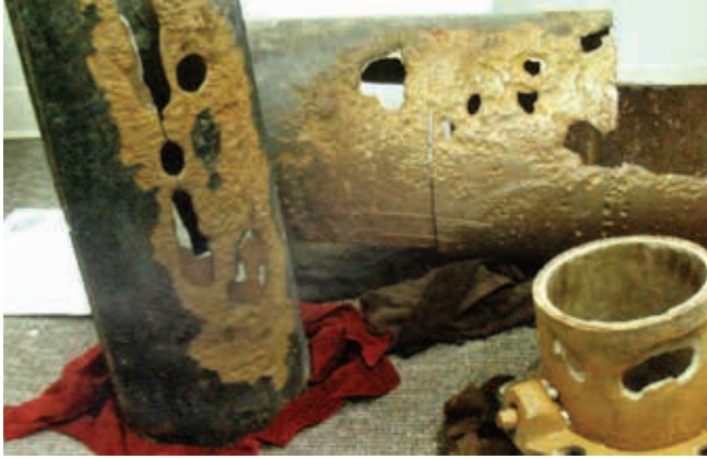
Ryc. 6. Stan przewodów wodociągowych przed bezwykopową wymianą [1]
