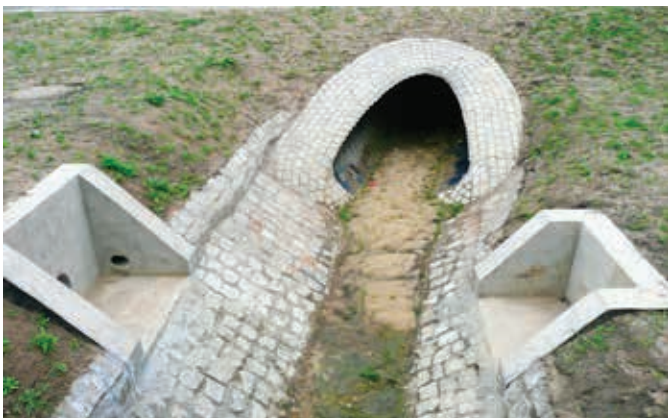
Ryc. 5. Przykład dna cieku i skarp umocnionych kostką granitową
