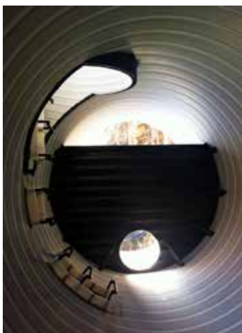
Wnętrze retencyjnego kanału ściekowego z przegrodą piętrzącą wykonaną z PE-HD
