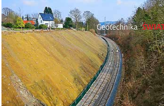
Ryc. 13. Zabezpieczenie wyciętego zbocza po osunięciu ziemi w zwietrzalej skale
