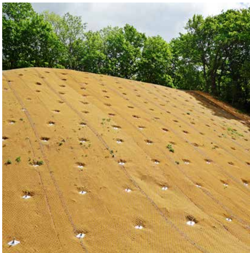
Ryc. 1. Równomiernie wyprofilowana skarpa w luźnej skale ze ściśle przylegającą matą zabezpieczającą przed erozją
