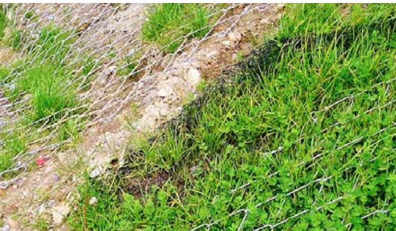
Ryc. 10. Obszar testowy ok. 10 tygodni po wykonaniu hydrosiewu oraz po obfitym deszczu. Po lewej stronie powierzchnia kontrolna bez maty zabezpieczającej przed erozją z mniej niż 10-procentowym efektem zazielenienia. Po prawej obszar z geomatą i efektem zazielenienia powyżej 90%
