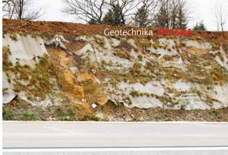
Ryc. 3. Niepoprawnie dobrane i wykonane oblicowanie – siatka stalowa o wysokiej odkształcalności nie pozwala na właściwe opięcie czoła skarpy, co skutkuje powstawaniem i eskalacją zsuwów powierzchniowych
