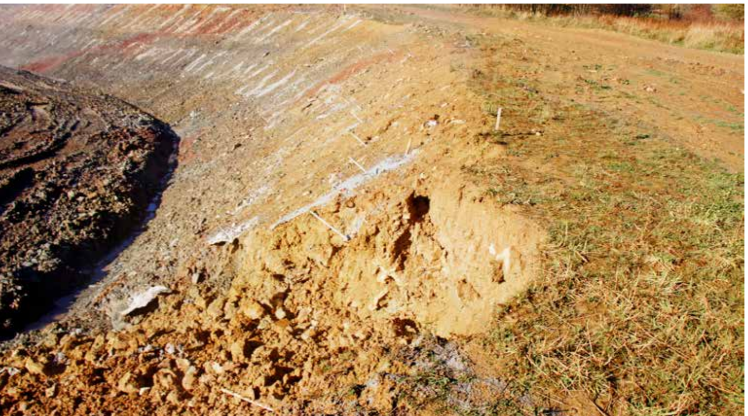
Ryc. 1. Skarpa pogłębiona do czterech poziomów roboczych, gwoździe poziomów wyższych instalowane w jednym etapie bez jednoczesnej instalacji oblicowania i drenażu, w wyniku czego doszło do osunięć gruntu
