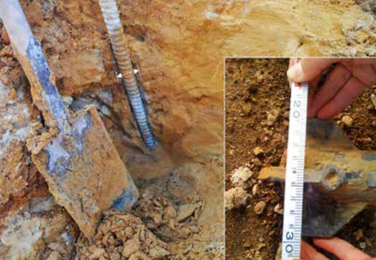
Ryc. 2. Gwoździ gruntowy samowierzący wiercony prawdopodobnie bez płuczki cementowej i z nieprawidłowo wykonaną iniekcją wtórną (trzon iniekcyjny o średnicy znacznie mniejszej niż koronka wiertnicza)
