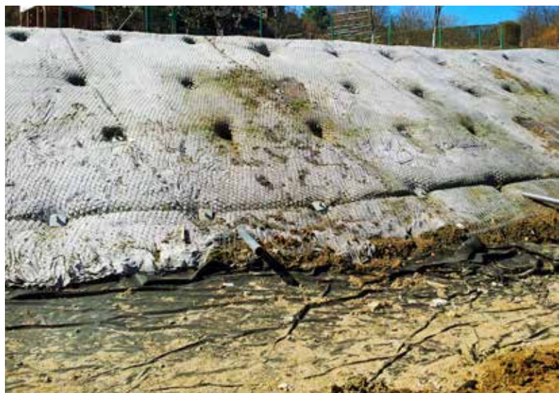
Ryc. 4. Skarpa gwoździowana ze znaczącymi deformacjami powstałymi wskutek niekontrolowanego nawodnienia (widoczne wycieki wody gruntowej) przy braku systemu monitoringu i stosownej interwencji
