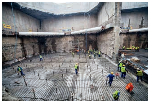
Ryc. 3. Przykład obudowy ze ścianą szczelinową i kotwionym poziomym ekranem Soilcrete® – budowa tunelu pod Martwą Wisłą w Gdańsku
