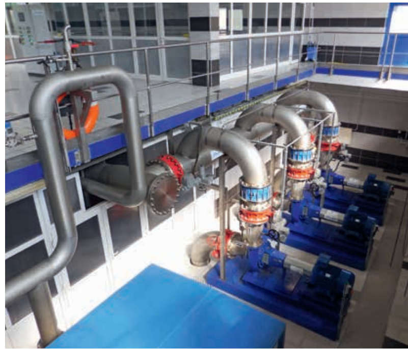
Pompownia wody uzdatnionej
