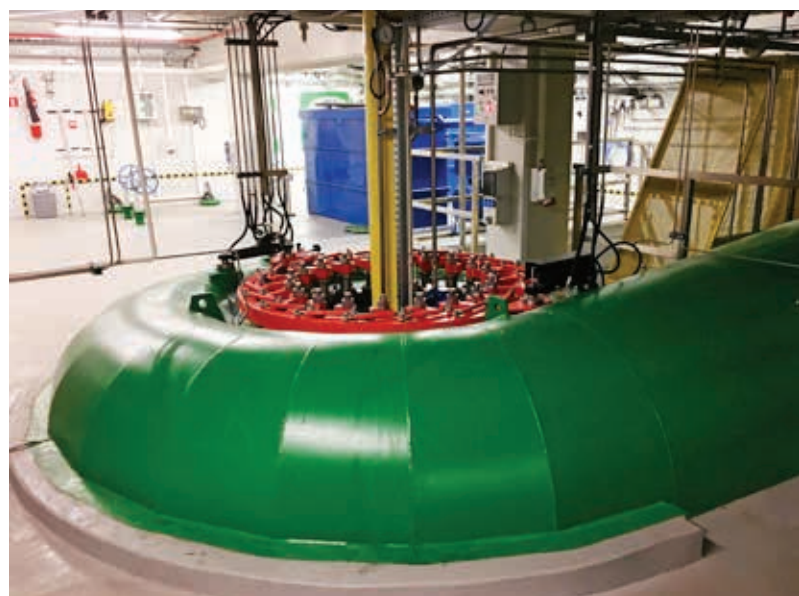
Przy zaporze powstała elektrownia wodna z dwiema turbinami Kaplana o łącznej mocy 4,4 MW
