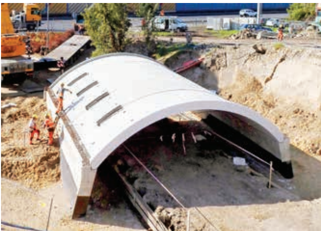
Ryc. 11. Obiekt na linii obwodowej Warszawy, aktualnie w trakcie realizacji. Widoczne zamki zamiast płyty uciągającej
