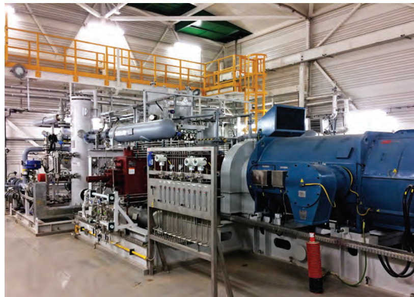
Zestaw sprężarkowy do powrotnego zatłaczania gazu w kopalni Dębno (BMB), fot. P. Czemyrs, KRNiGZ Dębno
