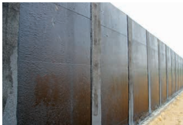
Ryc. 6. Widok bitumicznej izolacji powłokowej na pionowej powierzchni prefabrykatów żelbetonowych. Widoczne dodatkowe uszczelnienie w obrębie styków segmentów prefabrykowanych za pomocą izolacji arkuszowej – papy termozgrzewalnej, fot. A. Wysokowski
