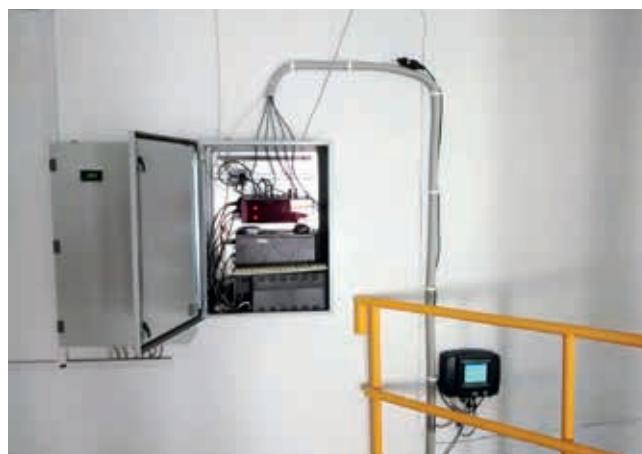
Ryc. 5. Szafa pomiarowa na os. Złoty Wiek
