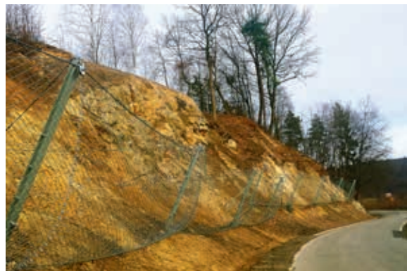
Bariera przeciwdziałkowa firmy Geobrugg AG w Kamyku, fot. Zakład Inżynierski Georem Sp. z o.o.
