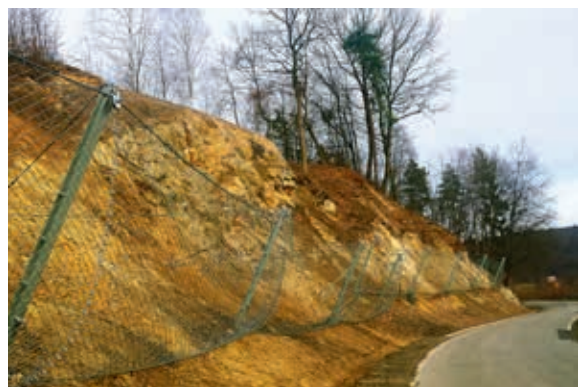
Bariera przeciwoślamiowa firmy Geobrugg AG w Kamyku, fot. Zakład Inżynierski Georem Sp. z o.o.
