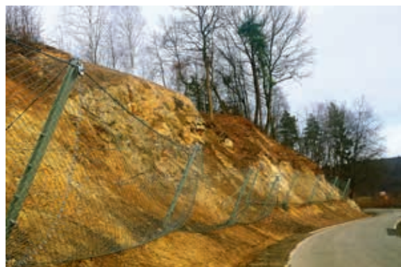
Bariera przeciwoślamiowa firmy Geobrugg AG w Kamyku, fot. Zakład Inżynieryjny Georem Sp. z o.o.
