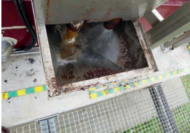
Instalacja deamonifikacji – recykulacja granulek osadu Anammox
