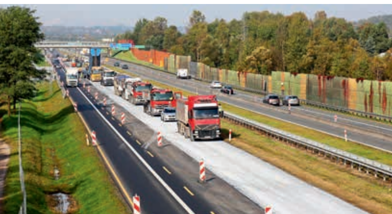
Wymiana warstwy ścieralnej wraz z zabezpieczeniem warstwy szczepnej podczas remontu autostrady A4, fot. Pavimental
