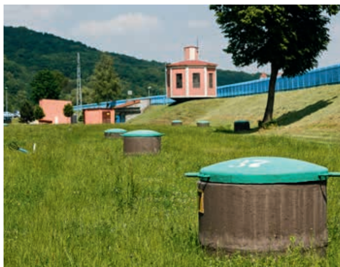
Studnie głębinowe ujmujące wodę do rurociągu lewarowego
