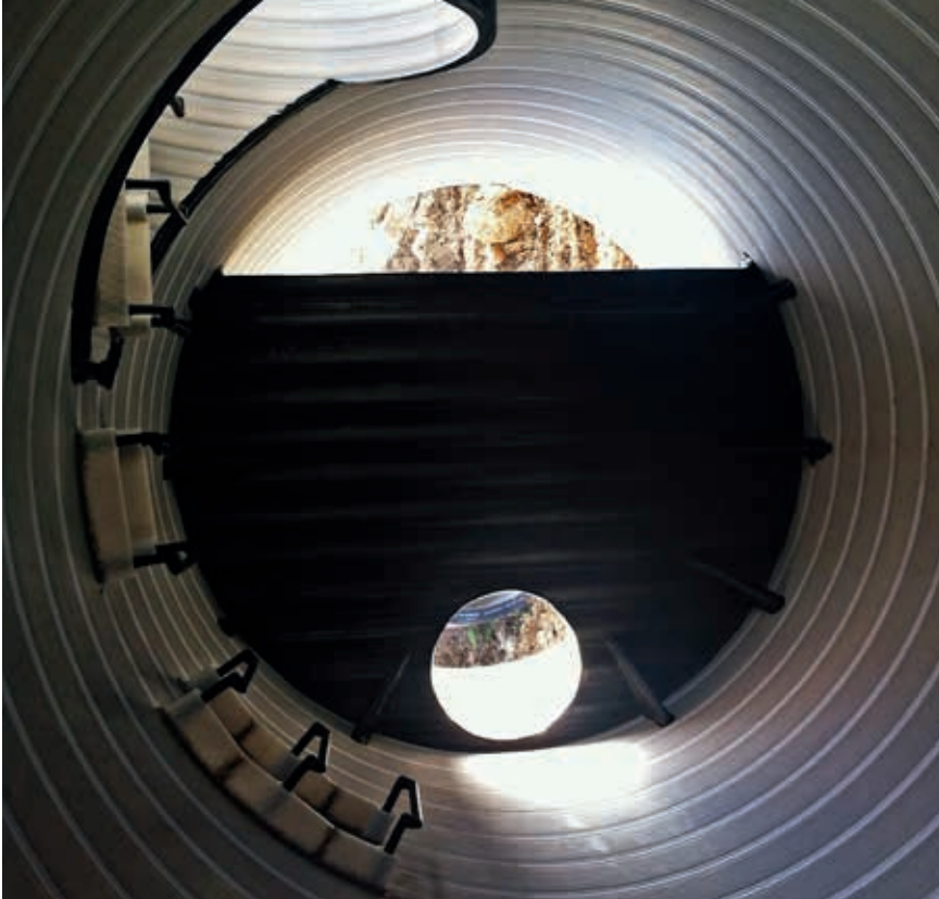
Wnętrze retencyjnego kanału ściekowego z przegradą piętrzącą, fot. Uponor Infra Sp. z o.o.
