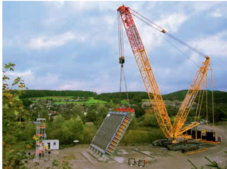
Ryc. 2. Układ pomiarowy pełnoskalowego testu kombinacji elastycznej siatki stabilizującej i gwoździowania, fot. Geobrugg AG
