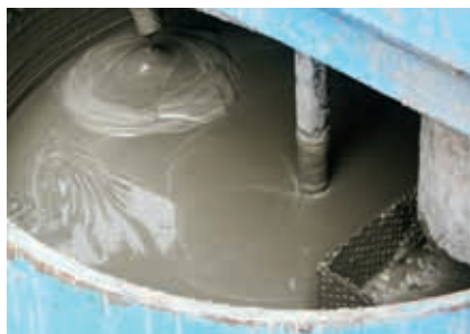
Ryc. 13. Zbiornik zaczynu cementowego do iniekcji
