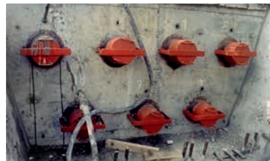
Ryc. 10. Widok czoła konstrukcji z otworami odpowietrzników powyżej zakotwień, fot. P. Gwoździewicz
