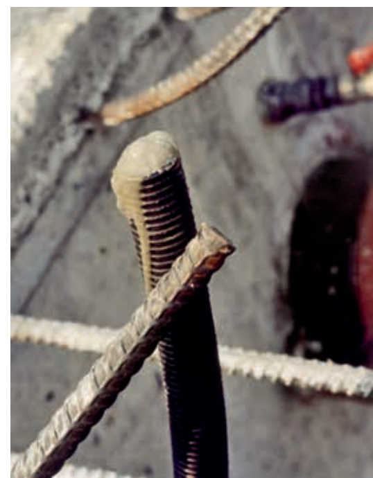
Ryc. 11. Widok rurki odpowietrzającej kanał kablowy na końcu konstrukcji, wypływający spieniony zaczyn cementowy, fot. P. Gwoździewicz
