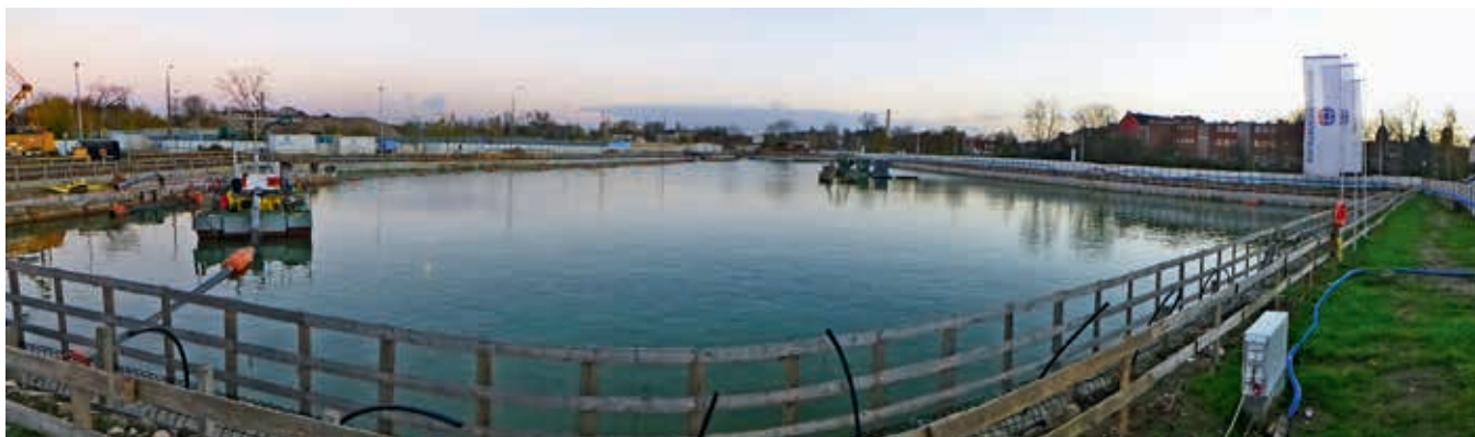
Widok budowy w trakcie wykonywania refulacji, fot. archiwum Soletanche Polska Sp. z o.o.
