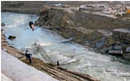
Ryc. 17. Przykład stabilizacji koryta w sąsiedztwie mostu – ochrona filarów mostu przez zastosowanie elastycznych barier przeciwrumowiskowych
