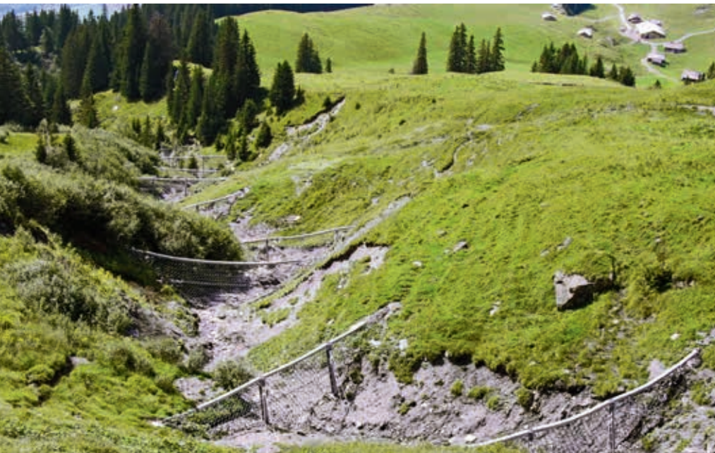
Ryc. 6. Układ barier elastycznych zainstalowanych w korycie potoku, w którym okresowo pojawiają się spływy gruzowe
