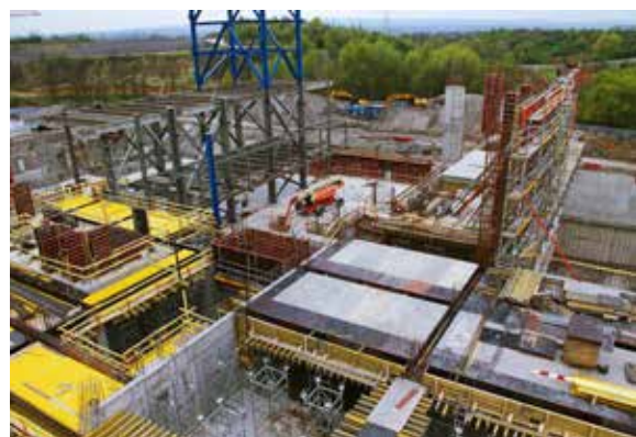
Główny budynek procesowy ZTPO – widok na halę kotłową i stację transformatorową (część elektryczną budynku głównego)
