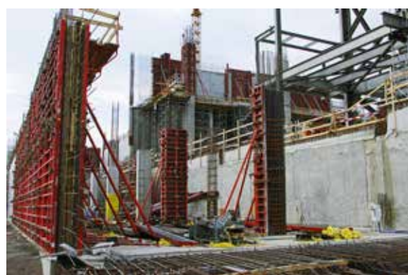
Główny budynek procesowy ZTPO – widok z pomieszczenia sprężarkowni na halę kotłową i bunkier
