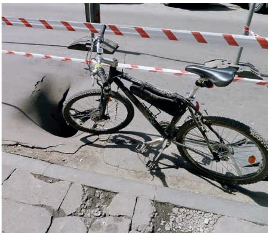
Ryc. 7. Zapadnięta nawierzchnia uliczna nad nieszczelnym kanałem, fot. E. Kuliczowska
