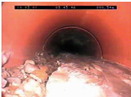
Ryc. 5. Osad stały w nowym przewodzie kanalizacyjnym [3]
