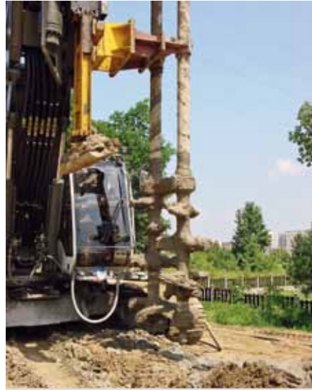
Ryc. 2. Wykonanie kolumn w technologii DSM podwójnym mieszkankiem, źródło: Keller Polska Sp. z o.o.
