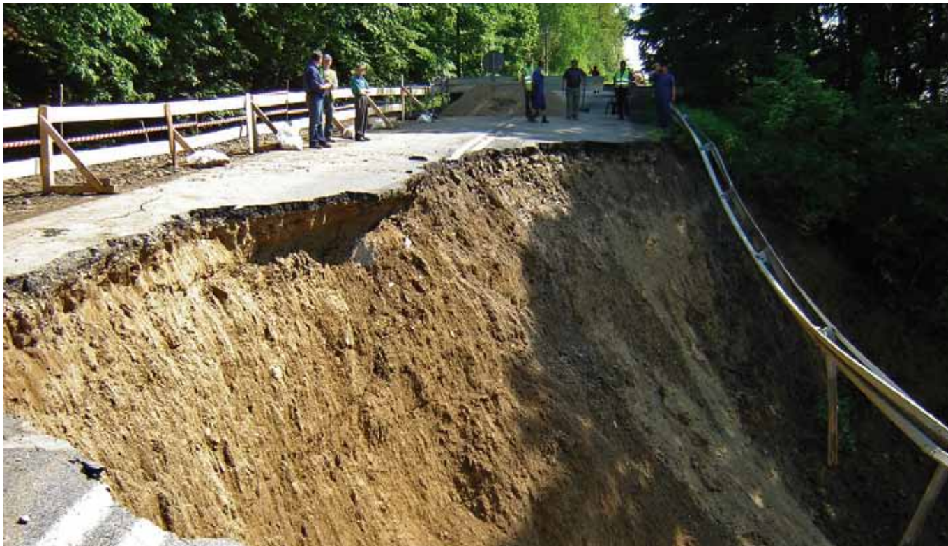
Osuwisko w ciągu drogi wojewódzkiej nr 975 w miejscowości Kurów, fot. ZDW Nowy Sącz
