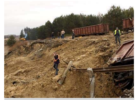
Ryc. 5. Awaria nasypu kolejowego
