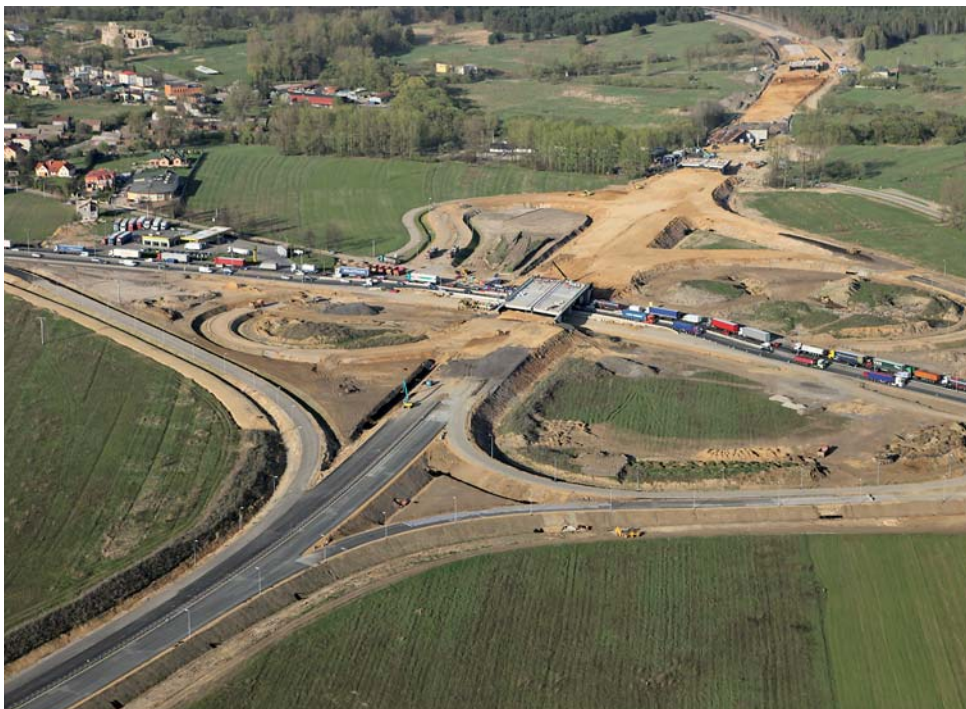
Węzeł drogowy DK78 z DK1, w tle widoczny most przez rzekę Czarna Przemsza
