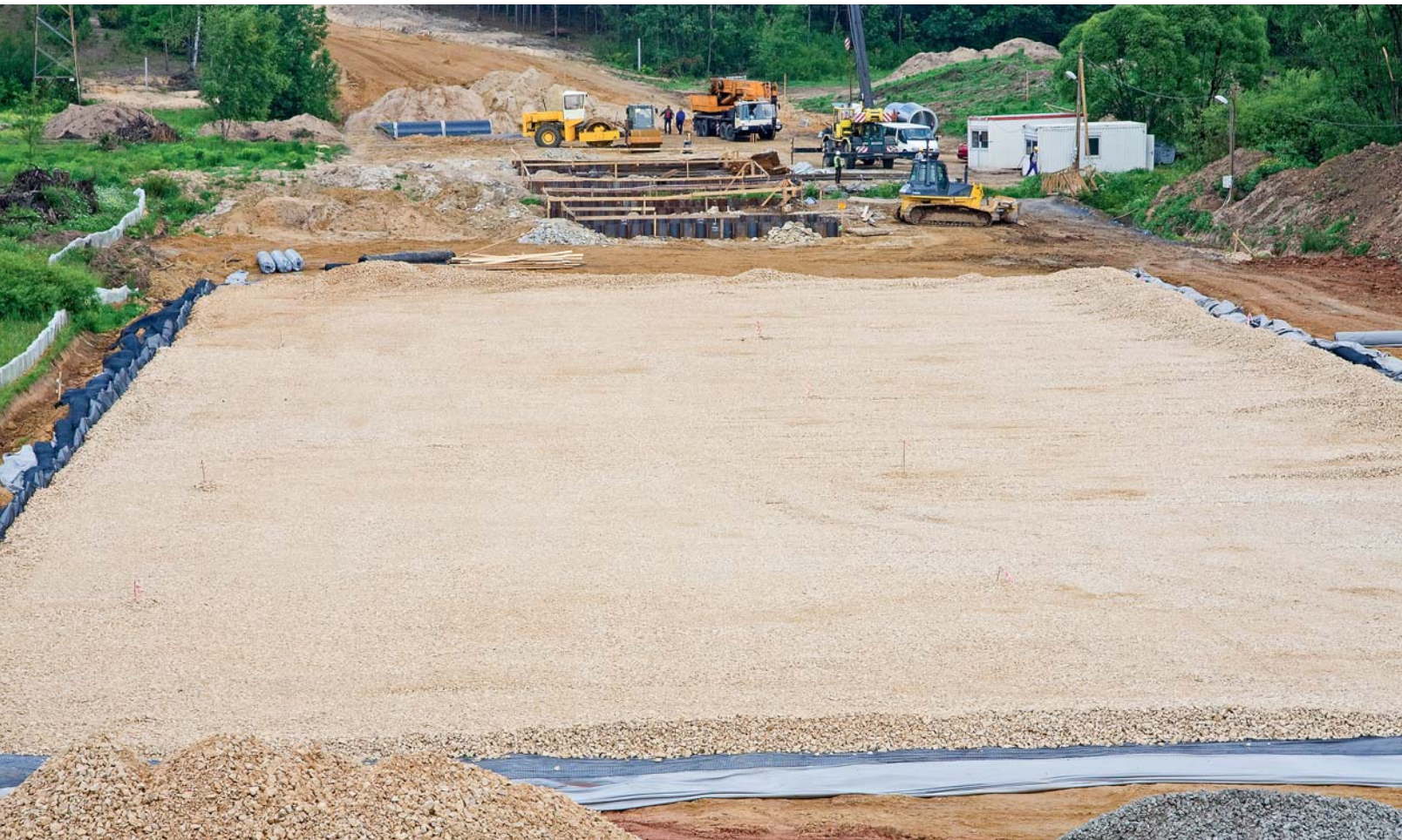
Budowa obwodnicy na odcinku pomiędzy wiaduktem w ciągu DK78 nad ul. Krakowską (w km 3 + 121,97) a wiaduktem w ciągu DK78 nad drogą gruntową (w km 4 + 897,06)
