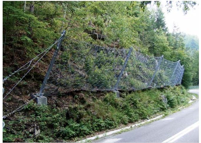
Ryc. 6. Bariera RXI-025 (na 250 kJ) zainstalowana przy drodze wojewódzkiej nr 971
