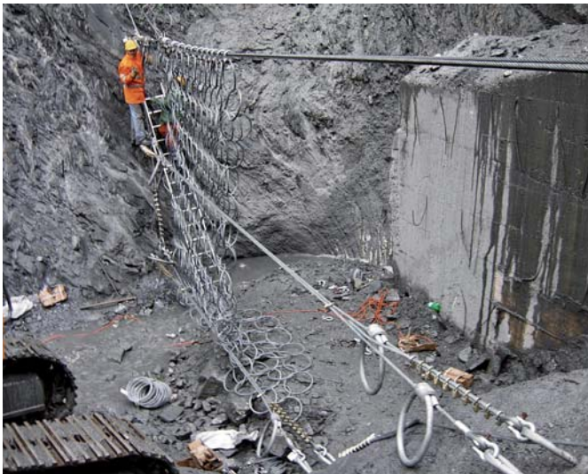
Ryc. 11. Instalacja siatki pierścieniowej bariery gruzowej typu VX. Widoczny układ kotew, lin i pierścieni bezpieczeństwa
