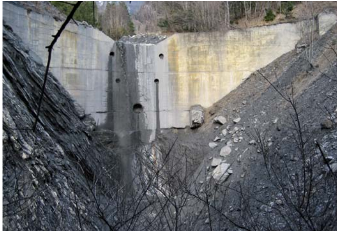
Ryc. 7. Widoczne uszkodzenia ciężkiej, żelbetowej bariery przeciwrumowiskowej
