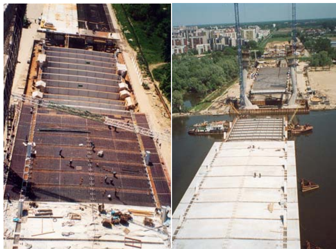
Ryc. 2. Stanowisko scalania konstrukcji stalowej, odcinek przeznaczony do betonowania płyty oraz część zabetonowanej i już przesuniętej konstrukcji
