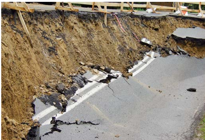
Osuwisko w ciągu drogi wojewódzkiej nr 975, Kurów, fot. ZDW Kraków
