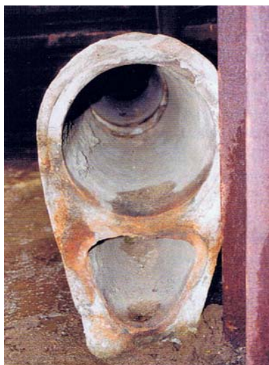
Ryc. 1. Odkopany prefabrykat kanałowy z Bydgoszczy z dwoma niezależnymi przekrojami [1]
