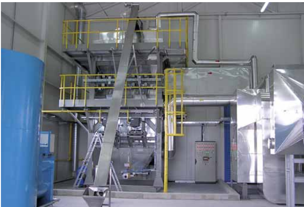
Komora do mineralizacji odpadów stałych wraz z systemem podawania
