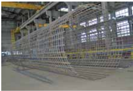
Zbrojenia do pali fundamentowych produkowane przez Poltech Sp z o.o.: najmniejsze i największe średnice
