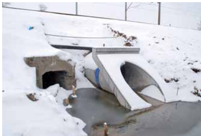
Ryc. 2. Przykład betonowego przepustu kolejowego o przekroju kołowym w trakcie realizacji; obok widoczny stary betonowy przepust skrzynkowy, fot. Consolis Polska Sp. z o.o.
