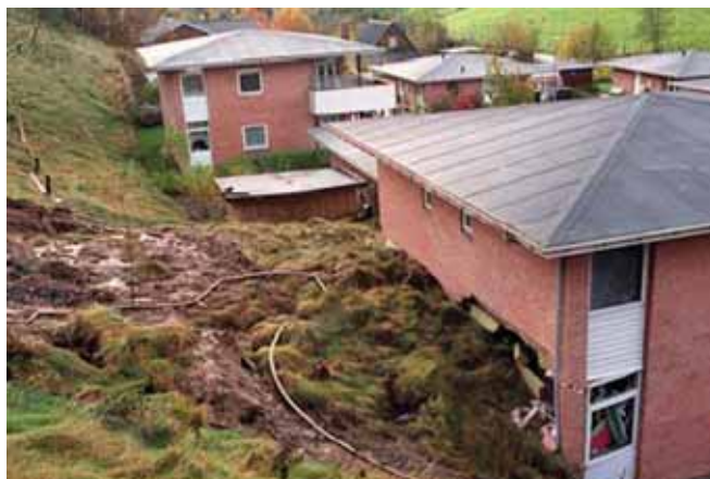
Skutki osuwiska w rejonie budynku oraz drogi na zboczu
