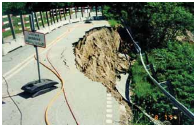
Osuwisko na drodze zlokalizowanej na zboczu górskim
