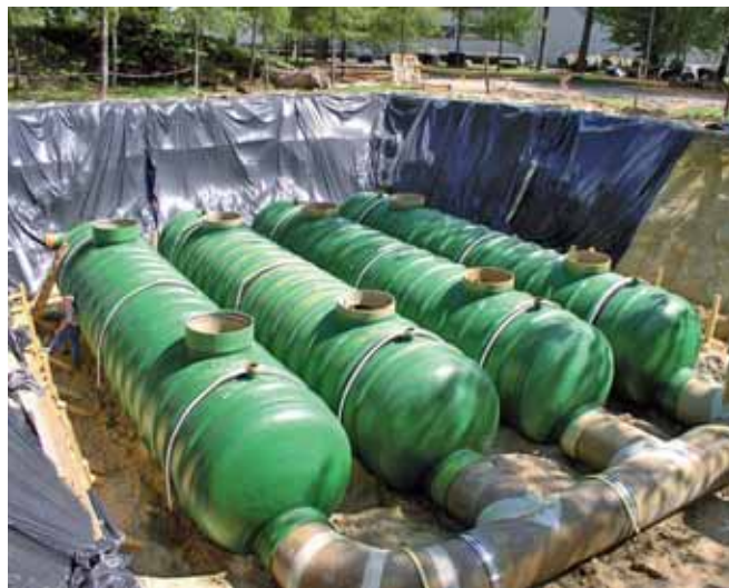
Zbiornik retencyjny wykonany na bazie prefabrykowanych zbiorników Flowtite
