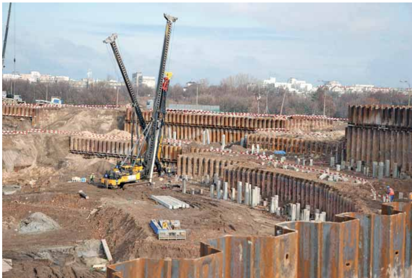
Pracujące kafary do wbijania pali prefabrykowanych na tle platform roboczych o zróżnicowanych poziomach projektowych, fot. archiwum NCS
