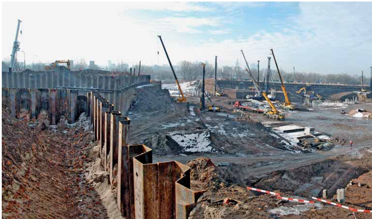
Panorama niecki stadionu z przygotowanymi do wbicia palami prefabrykowanymi oraz pracującym sprzętem, fot. archiwum NCS
