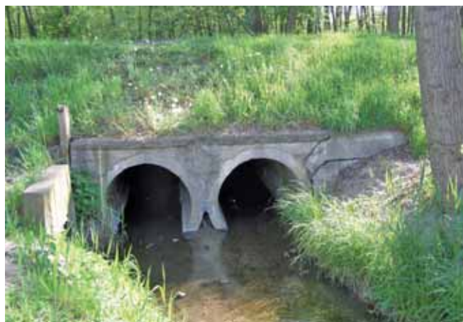
Ryc. 7. Dwukomorowy przepust drogowy bez możliwości migracji zwierząt [1]
