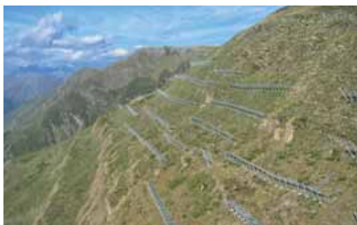
Ryc. 4. Widok zainstalowanych barier – minimalny wpływ na krajobraz oraz pewność rozwiązania
