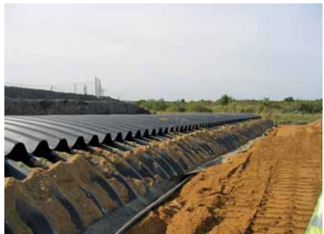
Ryc. 13. Przykład przepustu gruntowo-powłokowego z blach falistych w trakcie wykonywania zasyпки. Widoczne jest dodatkowe wzmocnienie konstrukcji w środkowej jej części, fot. Drotest Sp. z o.o.
