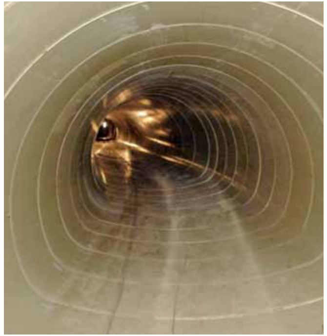
Ryc. 15. Przykład przepustu zrealizowanego z rur CC-GRP. Gładkie ścianki i trwały materiał ułatwiają utrzymanie konstrukcji, fot. Hobas Sp. z o.o.
