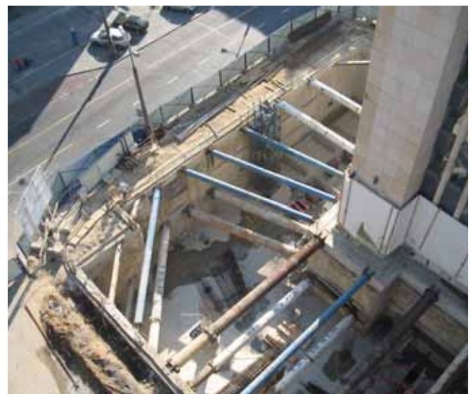
Ryc. 8. Rozparcie ścian szczelinowych w narożniku wykopu pod budynek NSA w Warszawie
