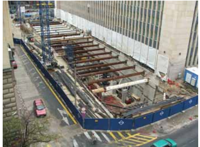
Ryc. 7. Wykop pod część podziemną budynku NSA w Warszawie w sąsiedztwie istniejącego budynku
