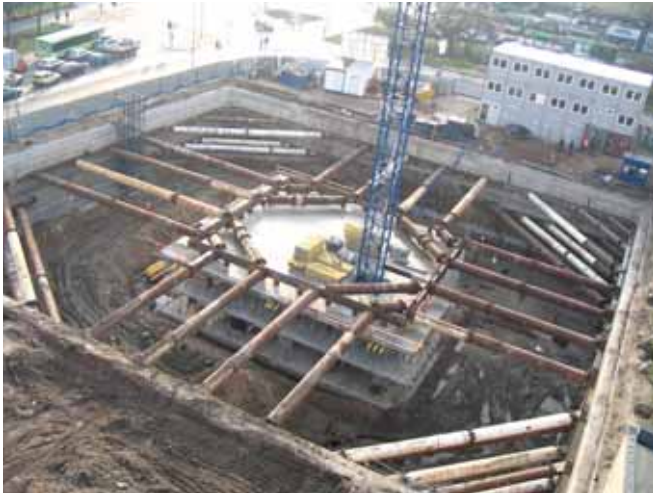
Ryc. 6. Widok rozparcia ścian szczelinowych z jego oparciem na centralnym fragmencie konstrukcji apartamentowca w Poznaniu
