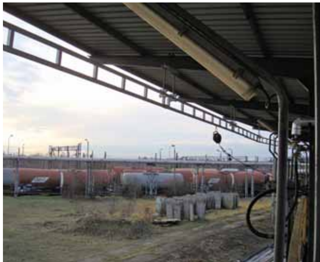
Poziomy system ochronny Traser na stacji załadunku cystern
