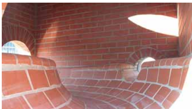
Kinetka z klinkieru w prefabrykowanej komorze kanalizacyjnej
