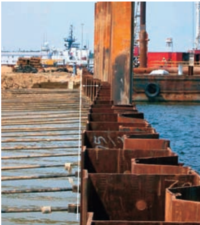
Ryc. 2. Widoczne odchylenie ściany kombinowanej od jej osi o 1,20 m
